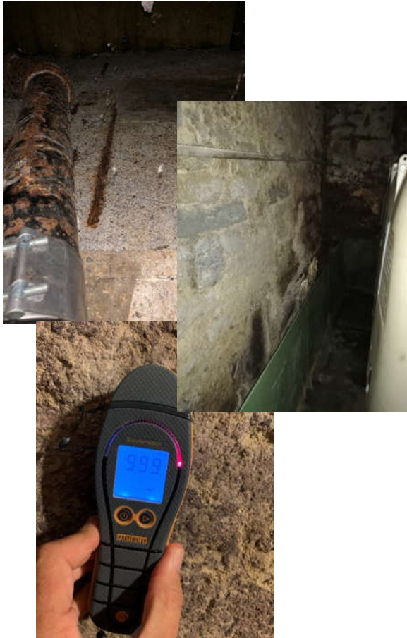
Schimmel Salpeter Befall
