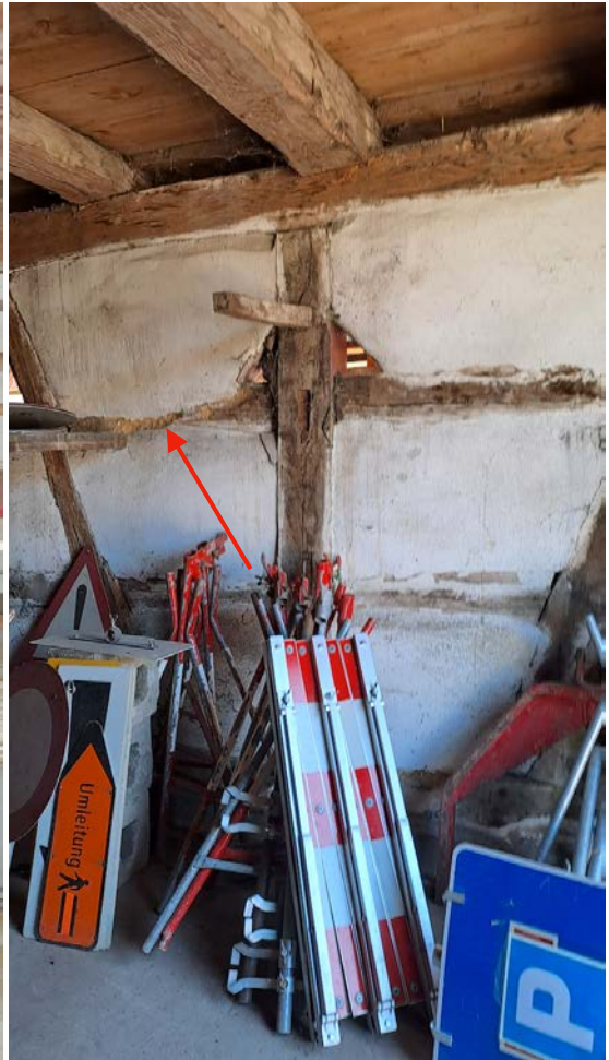
Schadstellen am Fachwerk.
