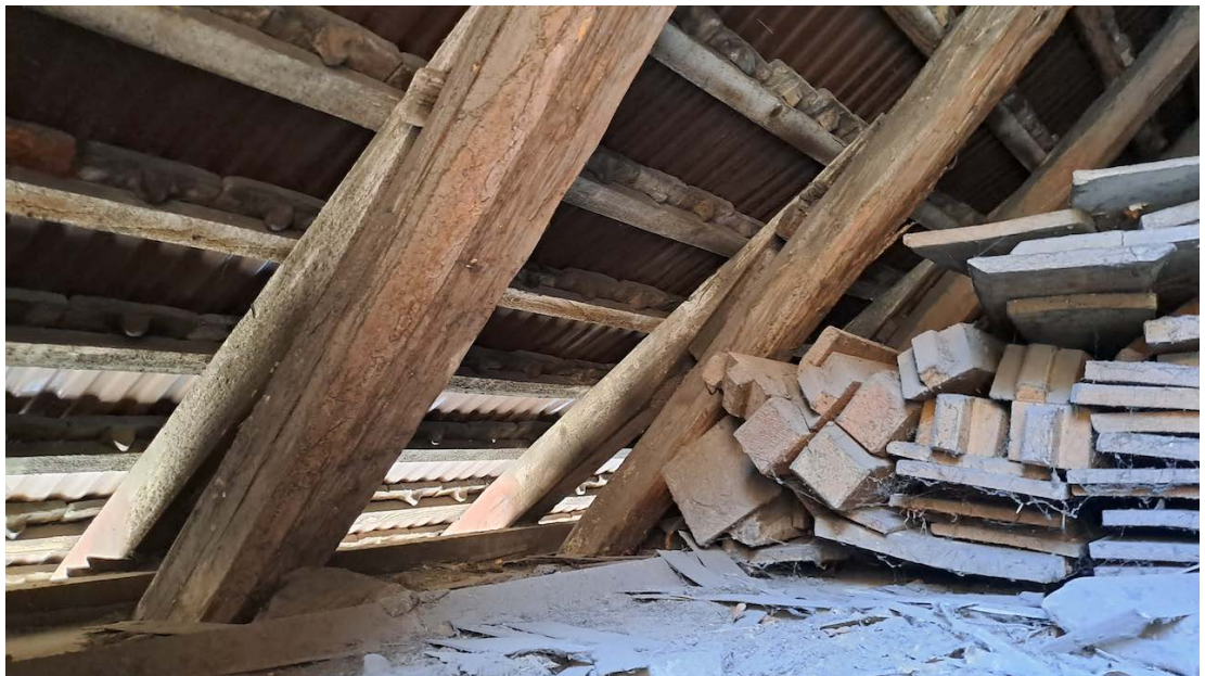
Sparren in Dachbalken verzapft, ersetzte Aufschieblingslage.
